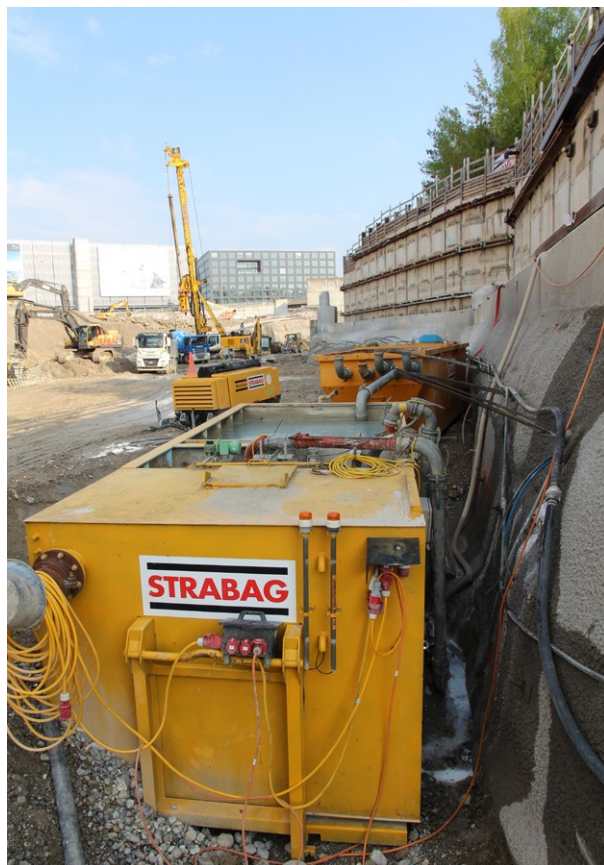
Vorbehandlung des alkalischen Baustellenabwassers in sogenannten Neutralisationsbecken.
