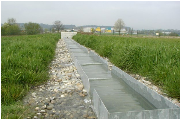
Überlaufrinne eines Retentionsfilterbeckens.
