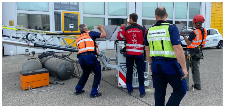
Die neue Sirene wird in den Rettungskorb gehievt und für den Transport in die Höhe gesichert.
